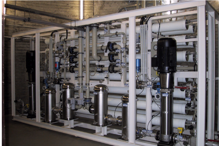
Ansicht der Umkehrosmoseanlage
