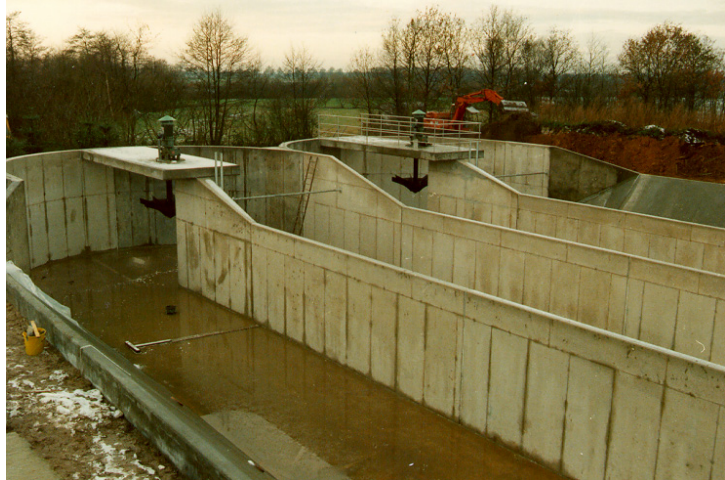
Belebungsbecken der Kläranlage
