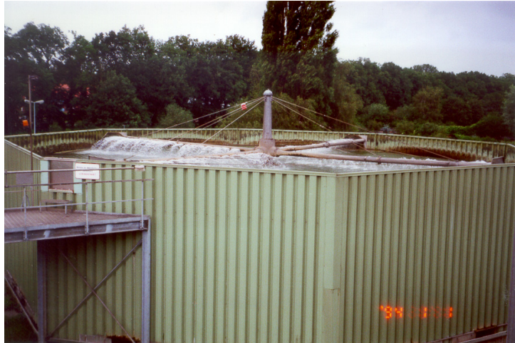
Tropfkörper der Betriebskläranlage
