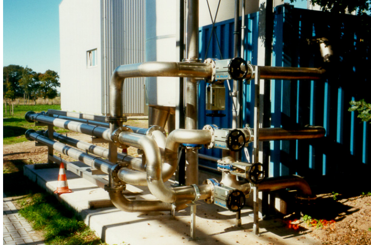
Wärmetauscher, Zwischenspeicher und Maschinenraum
