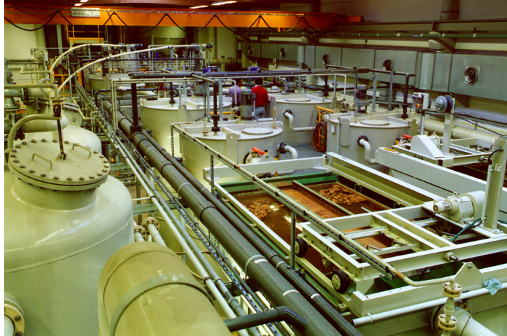
Zentrale Industrieabwasser-Behandlungsanlage (ZIB)
