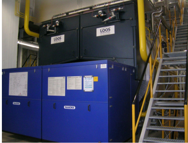
Frontansicht des Flammrohrkessels
